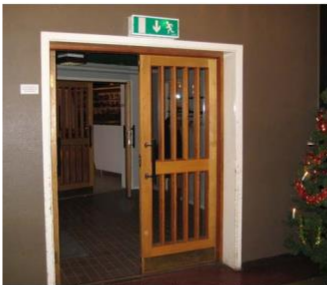
Figur 2 - Dörrar som ej bedöms uppnå förelagd klass
